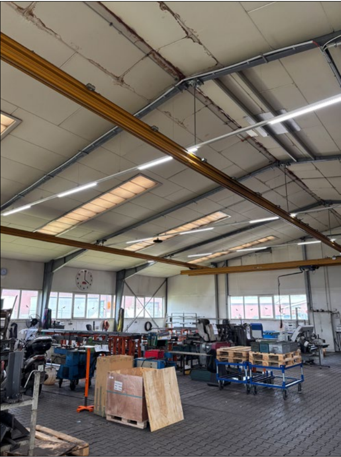
Optimas: Die Einführung einer LED Beleuchtung sorgt in der Sägerei für geringeren Stromverbrauch
